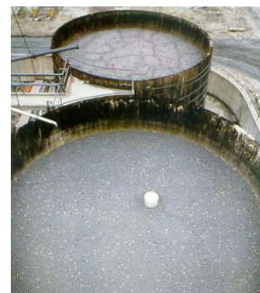
Couverture des cuves chimiques
